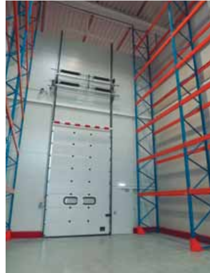
Dla produktów w łańcuchu zimnym (2–8°C) operator posiada nowoczesne komory chłodnicze o łącznej pojemności ponad 1000 miejsc paletowych, a także strefę dedykowaną obsłudze produktów kontrolowanych
