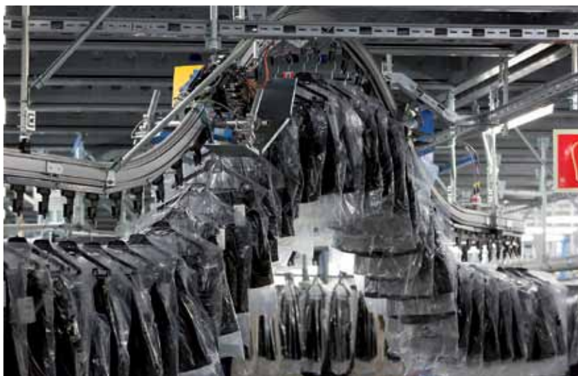
W centrach dystrybucyjnych i fabrykach zastosowanie znajdują systemy transportu podwieszanego – pozwalające na przemieszczanie odzieży na wieszakach. Takie rozwiązanie opiera się na systemie specjalnych szyn, po których przemieszczane są produkty na wieszakach lub lekkie wózki.
