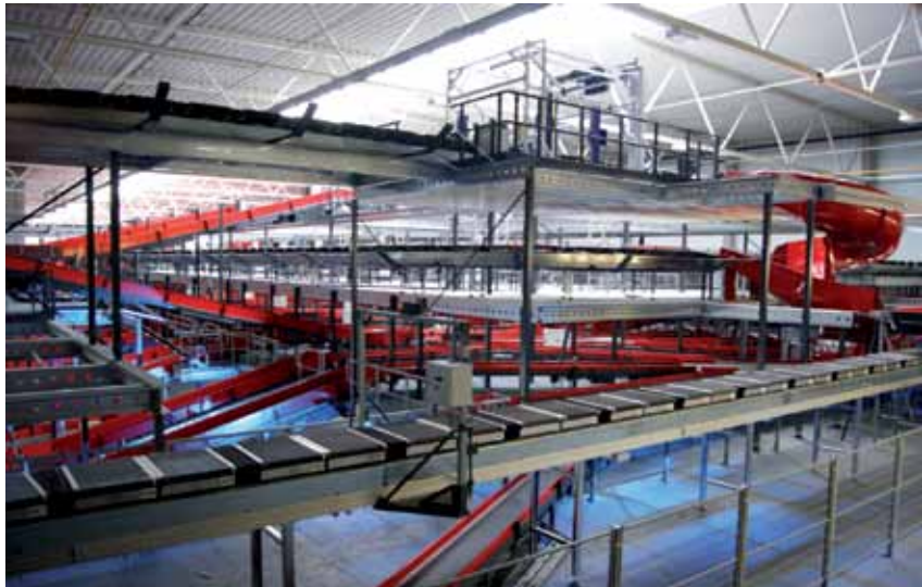
Sercem całej inwestycji jest tzw. duży sorter, składający się z dwóch linii, zawierających po 850 wózków każda. Wszystkie poruszają się z prędkością maksymalną 2,5 m/s, co zapewnia wydajność linii na poziomie 17,5 tys. paczek na godzinę.
