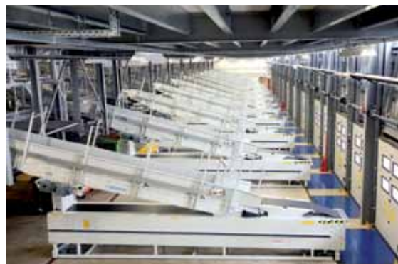
BEUMER Group wyposaża sortownik w moduły ze stanowiskami komisjonowania. Często instaluje się dodatkowe czujniki do wykrywania i korygowania ewentualnych błędów w celu podwyższenia dokładności sortowania
