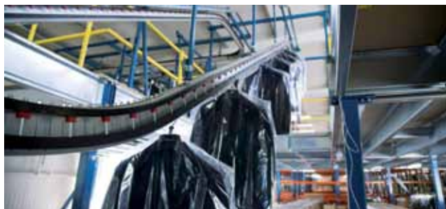
Przenośnik podwieszany łańcuchowo-wałowy OCA służy do transportu odzieży pomiędzy różnymi kondygnacjami magazynu, buforowania towaru (magazynowanie odzieży na wieszakach), a także pozwala na dostęp do każdej jednostki odzieży w dowolnym momencie
