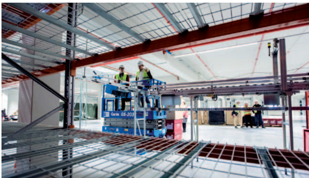
W zabudowie regałowej znajdzie się system tryskaczowy, chroniący magazyn na wypadek zagrożenia pożarowego, a ze względu na przepisy przeciwpożarowe wszystkie półki i podłogi są ażurowe
