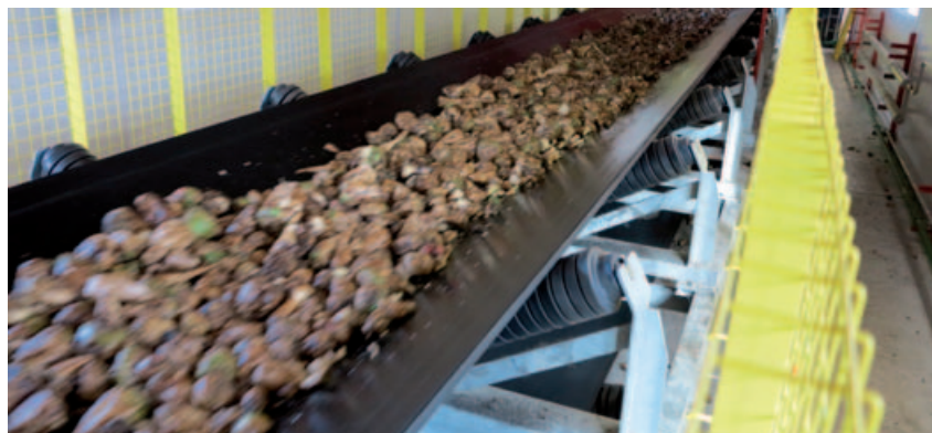
Jeśli żywność transportowana jest bezpośrednio na taśmie, najczęściej stosowane są krążniki z poliamidu i białe taśmy z atestem spożywczym. Dodatkowo w przenośnikach wykorzystywane są specjalne motoreduktory, które są odporne na kurz
