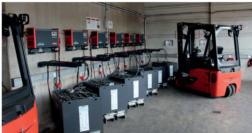
Wózki widłowe pracują po ok. 150 roboczogodzin w tygodniu – to możliwe tylko dzięki zastosowaniu akumulatorów zamiennych
