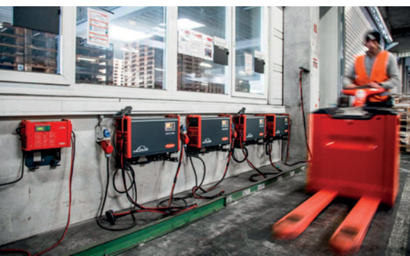
Od 2015 r. w centrali w Enns użytkowana jest nowa flota wózków widłowych – razem z wydajną energetycznie i kosztowo technologią ładowania akumulatorów firmy Fronius
