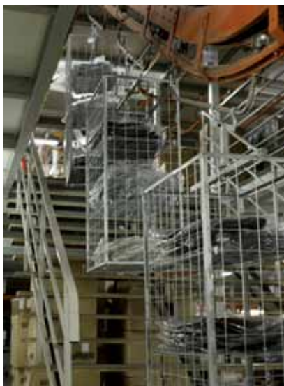
Spedimex na powierzchni magazynowej, dedykowanej dla odzieży, posiada park maszynowy, który znacznie ułatwia i przyspiesza obsługę sektora. W obiektach wydzielona została strefa magazynowa, wyposażona w regały statyczne oraz system przesuwny służący do przemieszczania ubrań
