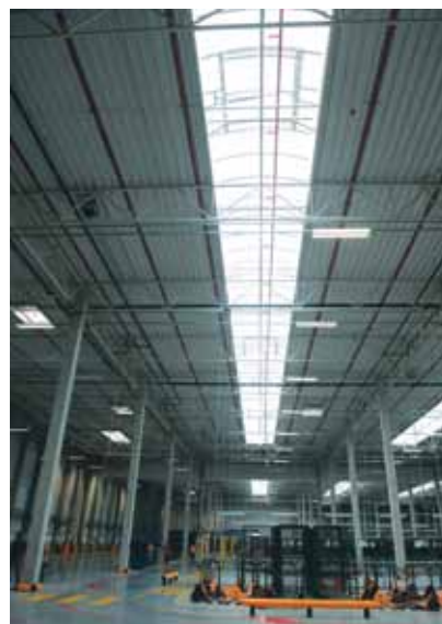
Zastosowano efektywne energetycznie rozwiązania, umożliwiające maksymalne wykorzystanie oświetlenia naturalnego, takie jak smart lighting (pozwala sterować oświetleniem stosownie do natężenia ruchu i dostępności światła dziennego w danym miejscu) i świetliki doświetlające przestrzeń
