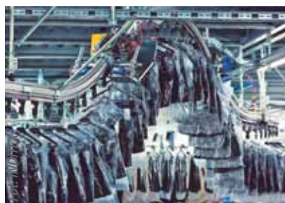
W centrach logistycznych stosowane są liczne systemy automatyki. Są wśród nich systemy transportu podwieszanego, pozwalające na przemieszczanie produktów umieszczonych na wieszakach
